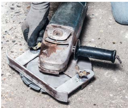
Damit die Diamantscheibe die Bewehrung vom Beton nicht beschädigt, haben wir uns aus drei Eisen eine Tiefenführung für den Winkelschleifer gebaut.
